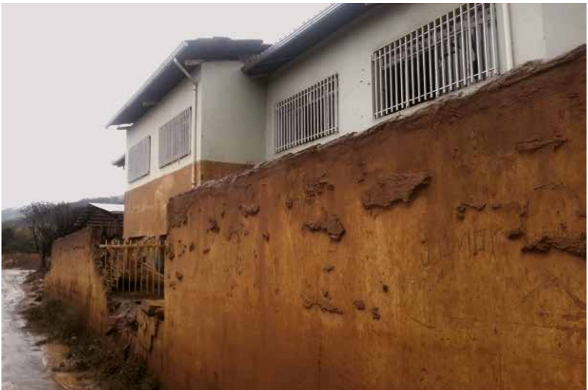
Muro da escola de Paracatu de Baixo
